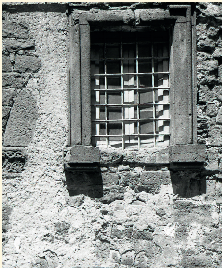
SAN MARTINO AL CIMINO. ABBAZIA DI SAN MARTINO AL CIMINO: INTERNO. FINESTRE CON LISTELLE DI LEGNO ROTTE. (MONTI PAOLO, 1972/06)
